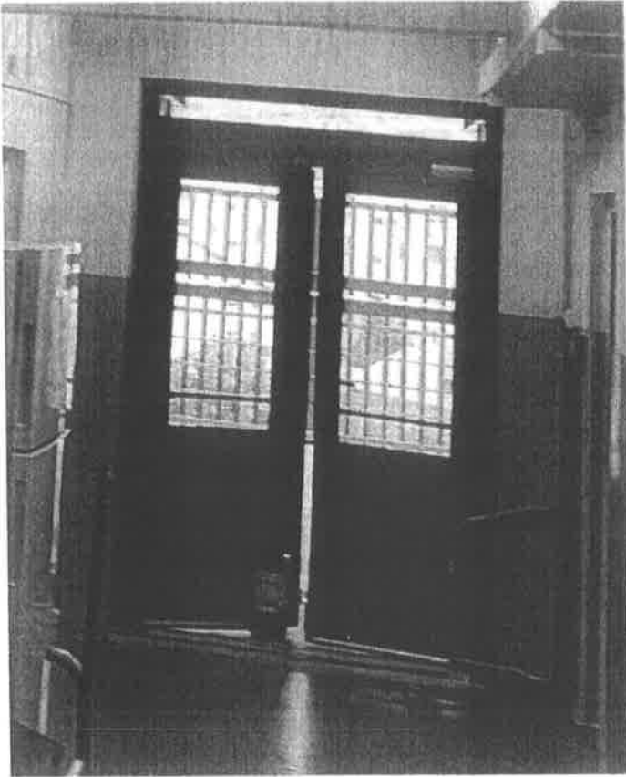
Lipsa iluminat evacuare usi scara exterioara
